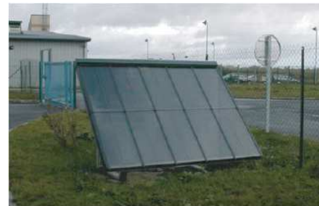
Le panneau solaire permettant de chauffer l'eau de la Déchèterie-Recyclerie
